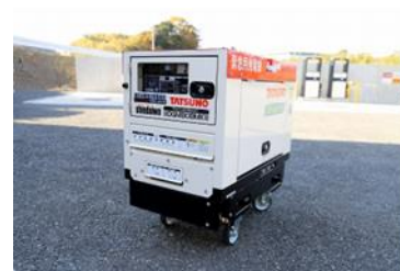
給油施設への非常用給電設備
