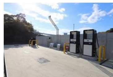
燃料タンクの地下化
